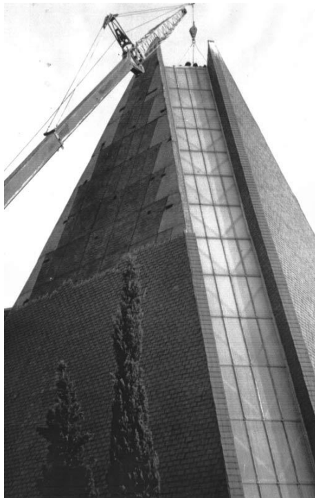
Fotografies on s'aprecia la pissarra de la teulada.
